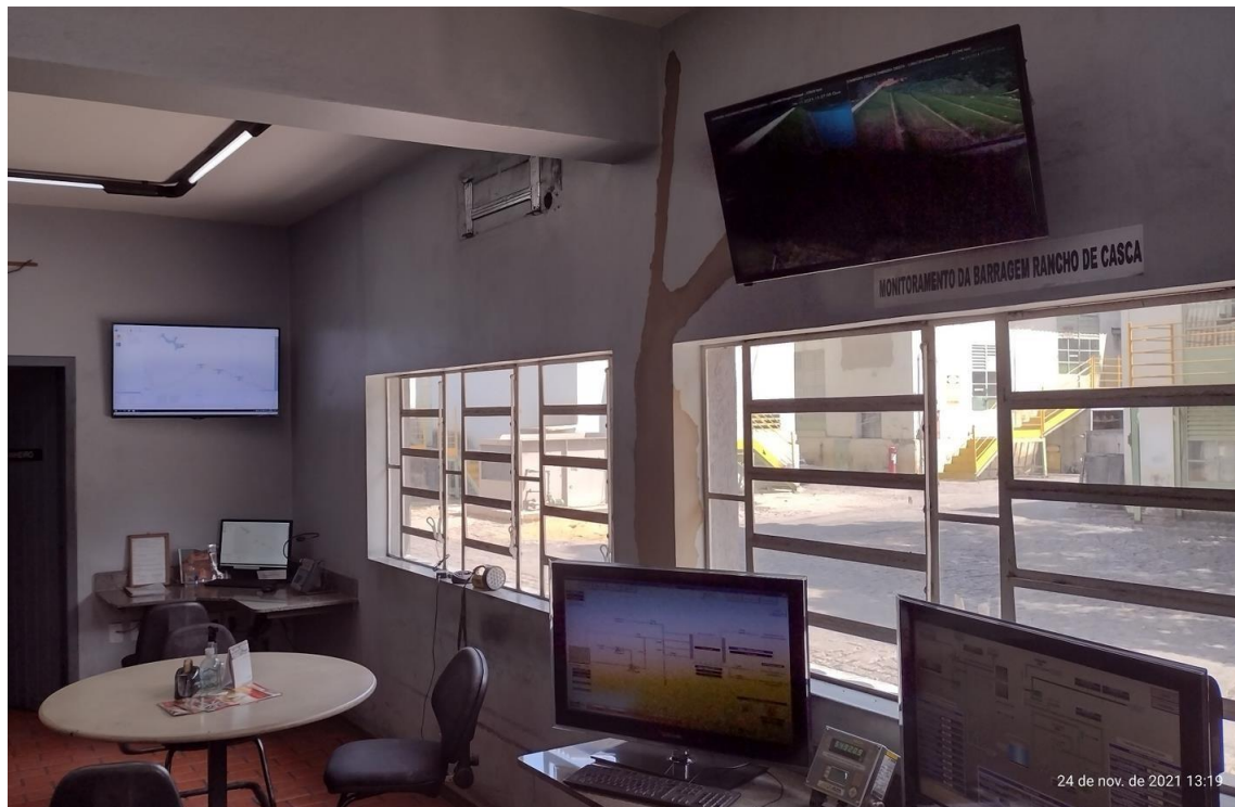
Figura 16.2 – Foto da sala de monitoramento e controle da barragem na unidade de Pedra Azul-MG
