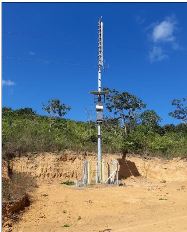
Figura 11.1 – Sirene implantada próximo a ZAS da mancha de inundação da Barragem Rancho Casca
